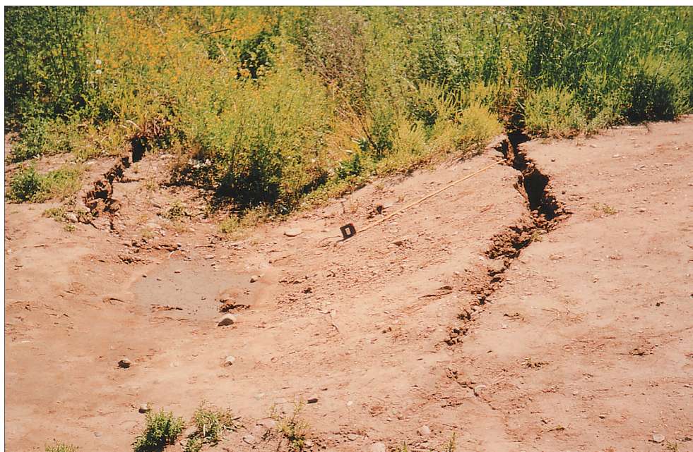
Рис. 2. Суффозионные провалы над трассой водонесущих коммуникаций летом 2001 г. в микрорайоне Университетский.
